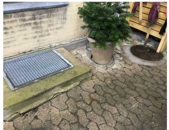
Belægningen har sat sig ved kloak/lyskasse. Opretning af belægning bør foretages, for at mindske risikoen for personskade..
