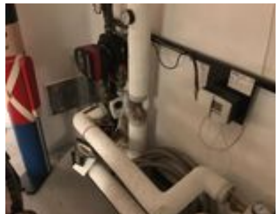
| Billede fra varmecentralen i kælderen
