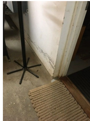
| Væggen lider af fugtproblemer.
