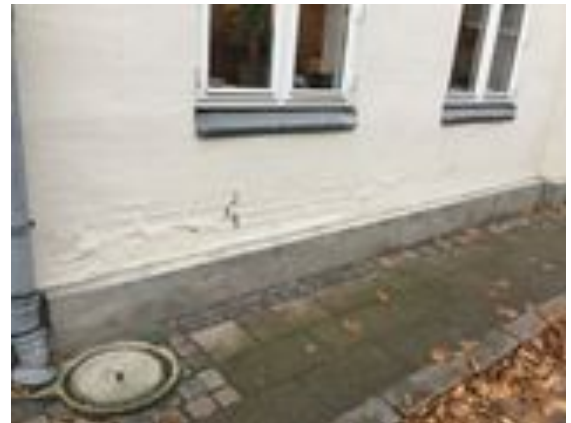
| Løs og opfugtet puds i nr. 7. .
