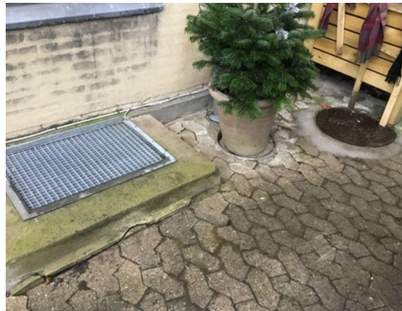
Belægningen har sat sig i området ved brønden..
