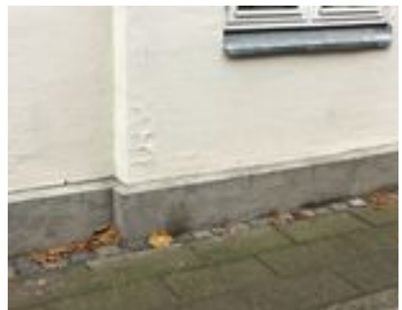
| Løs og fugtig puds i nr. 7.
