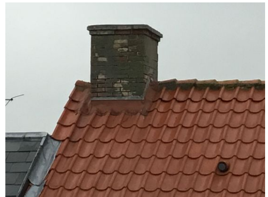
| Skorstenen med skadede fuger.
